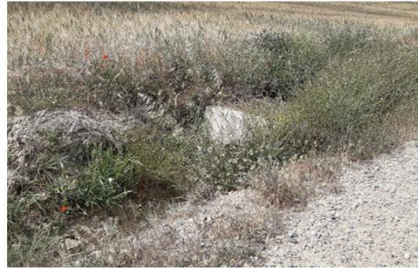
Fig. 2 Tubo de drenaje taponado por vegetación arbustiva en vial de acceso al aereo ML3.12. Fuente: Elaboración propia
