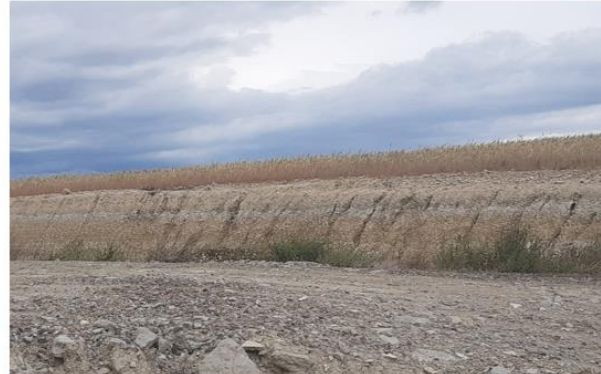
Fig. 2 Erosión hídrica en materiales margosos del talud de desmonte de plataforma del aro ML3.06. Fuente: Elaboración propia
